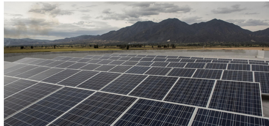
Paneles solares en CUVALLES.
